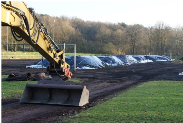
Entsorgung des mit Dioxin belasteten Aschenplatzes
